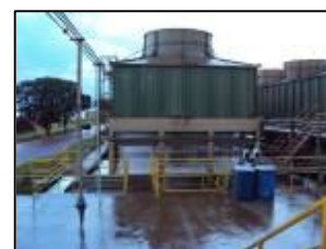
Figura 25 – resfriador de água.
