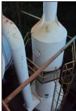
Figura 26 - torre de lavagem do CO 2 .
