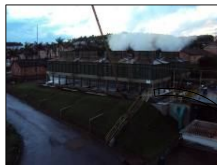
Figura 24 – resfriador de água.
